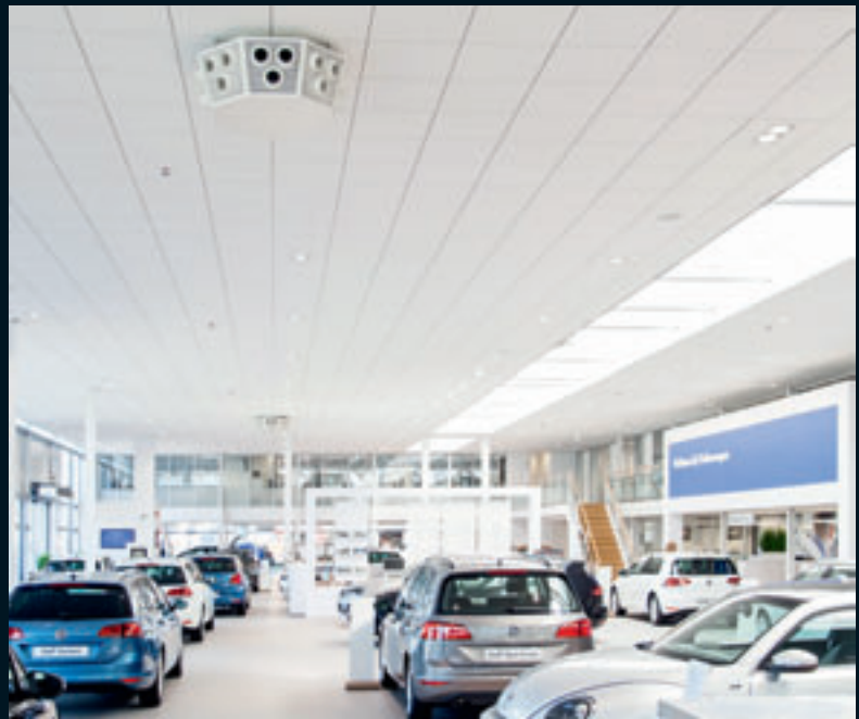
In de showroom en de kantoren beneden is voor het koelen en verwarmen gebruikgemaakt van twee Smitsair-JETsystemen. Deze units hebben verschillende uitblaasopeningen die in alle richtingen in de showroom geconditioneerde lucht uitwerpen.
