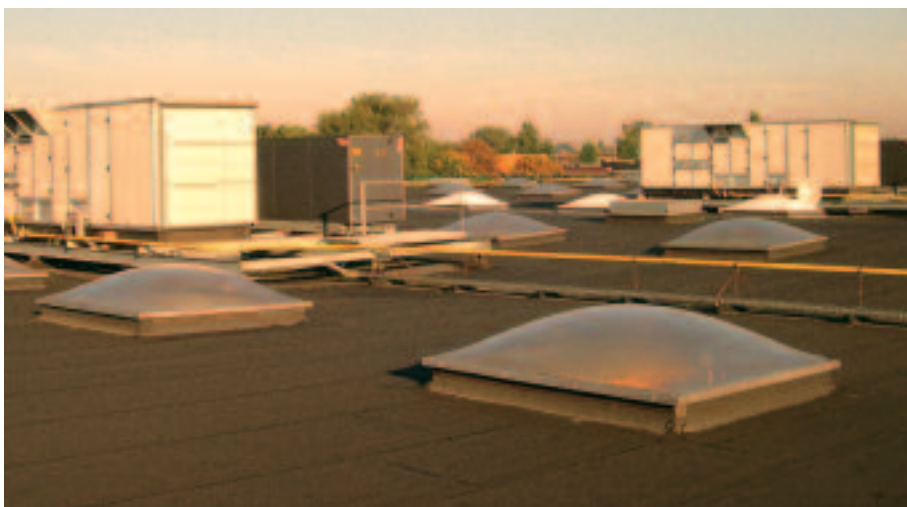
De Reznor luchtbehandelingskasten op het dak zorgen voor verwarming, koeling en ventilatie.
