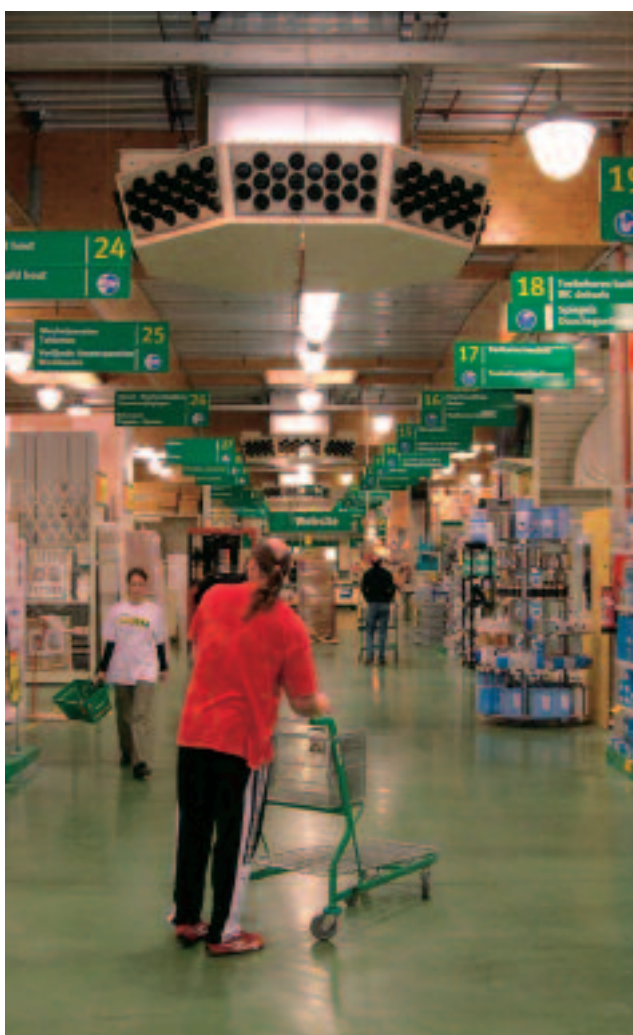
De installatie van de Brico in Borsbeek moest een aangenaam klimaat creëren voor klanten en werknemers
